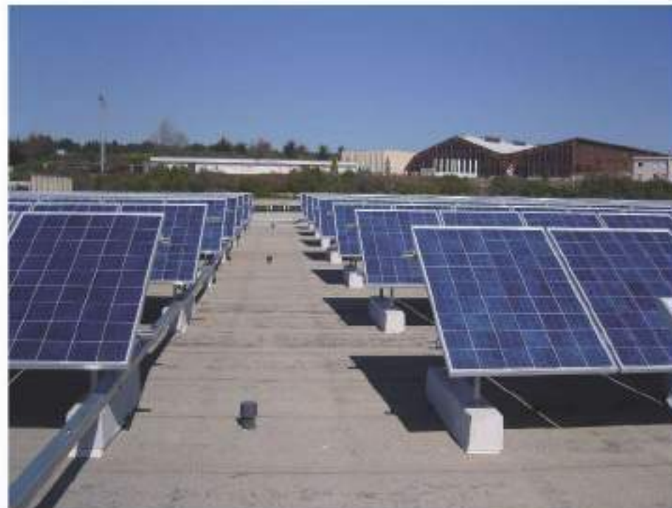
- Impianto fotovoltaico di Masseria Romaniello
